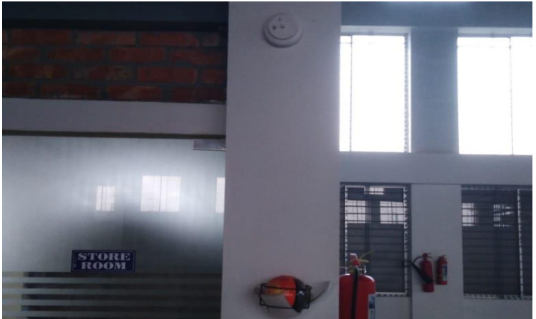
Fire Extinguisher (Auto)
