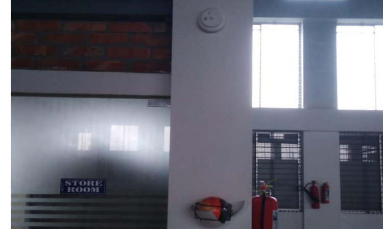
Fire Extinguisher (Auto)
